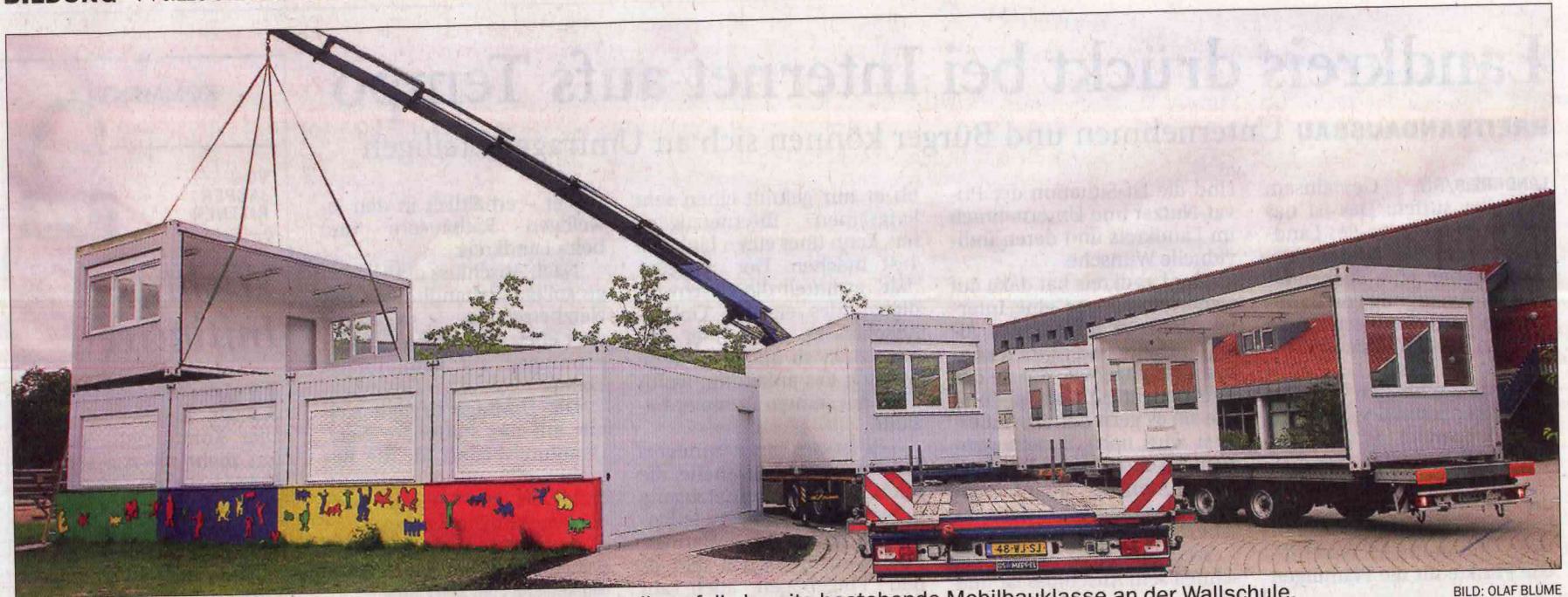
Am Haken: Ein Schwerlastkran hievt die einzelnen Containerteile auf die bereits bestehende Mobilbauklasse an der Wallschule.
