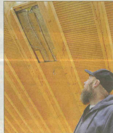
Loch in der Decke der Aula: Hier saß die schwere Akustikplatte.
